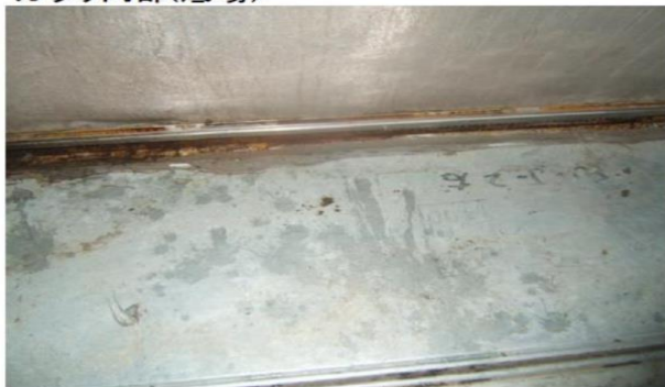
ガラリ内部(底場)
